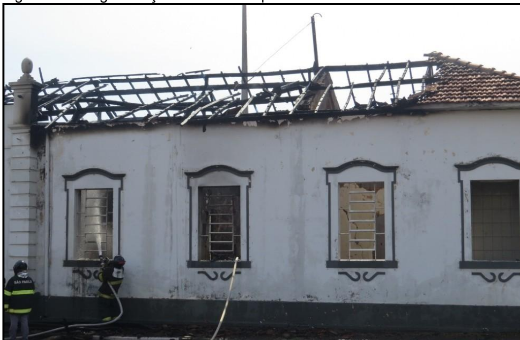
Figura 18- Antiga Estação Ferroviária após incêndio.
