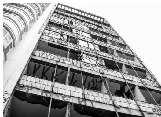
Figura 35 – Degradação da fachada
