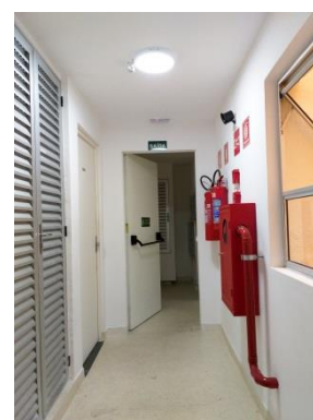
d) Hidrante, extintor e porta contrafogo
