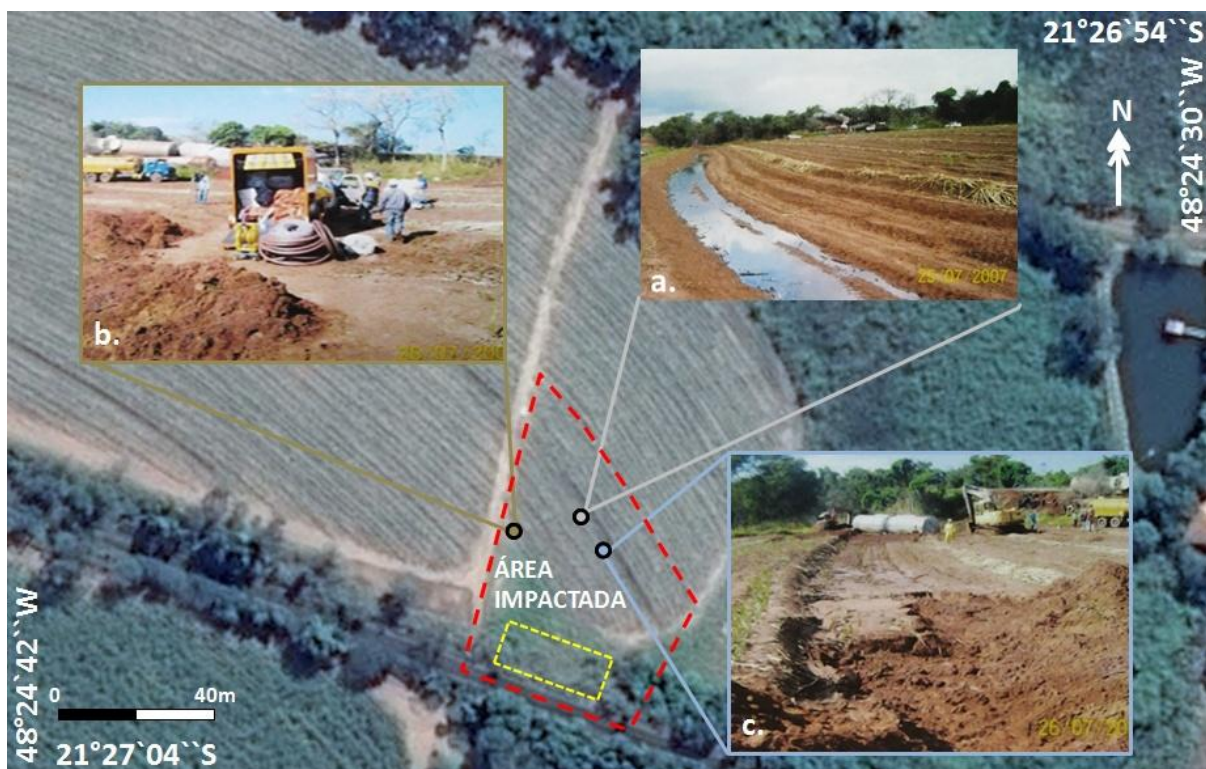
Figura 5. 2- Área impactada (tracejado vermelho) e local do tombamento dos vagões (tracejado amarelo). a. Imagem do acúmulo de óleo diesel na curva de nível; b. Operação de remoção de solo; c. Ao fundo da área contaminada, vagões tombados (Fonte: CETESB, 2007).
