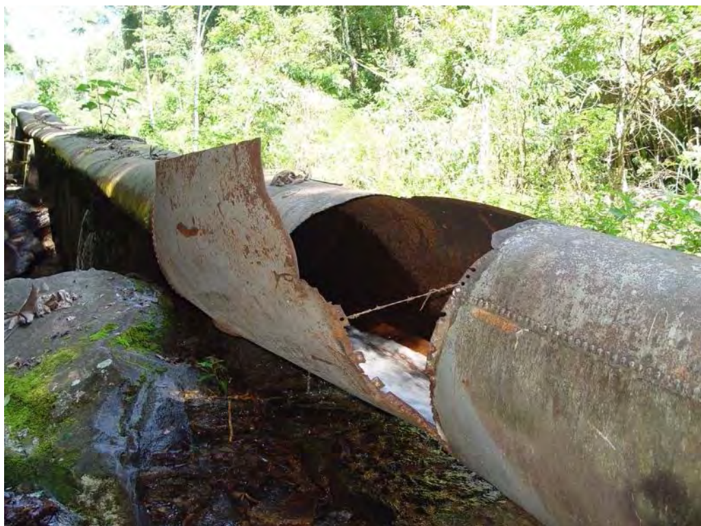
Figura 6: Efeitos do Golpe de Aríete no Conduto Forçado – PCH Sodré.
