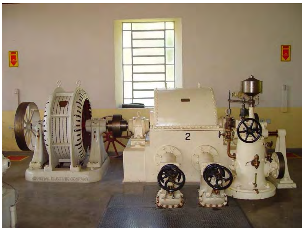
Figura 7: Grupo Turbina-Gerador – PCH Sodré
