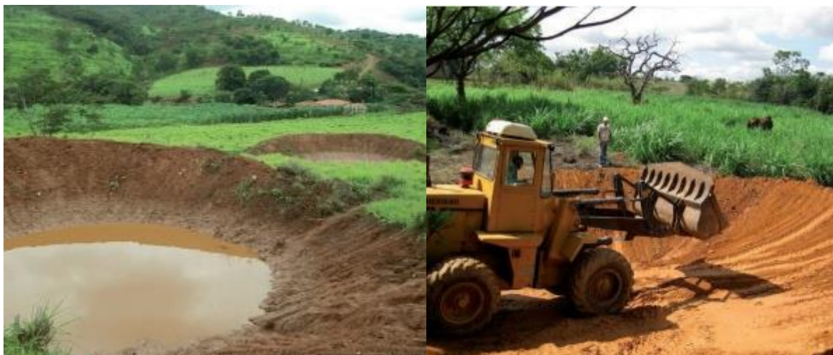
Figura 2: Barraginha em uso para a retenção de água da chuva e um lago de múltiplos usos em construção.
