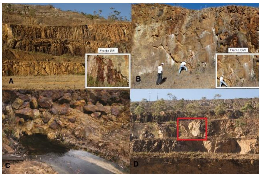
Figura 21: Principais passivos encontrados na área: A e B - surgência de água nos taludes evidenciada em B pelas manchas de caulinita (branco), C - surgência de água na base da pilha de estéril (BF-04), D – evidências de rupturas generalizadas nos taludes
