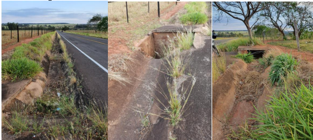
Figura 21 – linha de lançamento de águas pluviais do perímetro urbano ao Córrego Águas Claras, localizada às margens da SPV Rubens Carlos Herling
