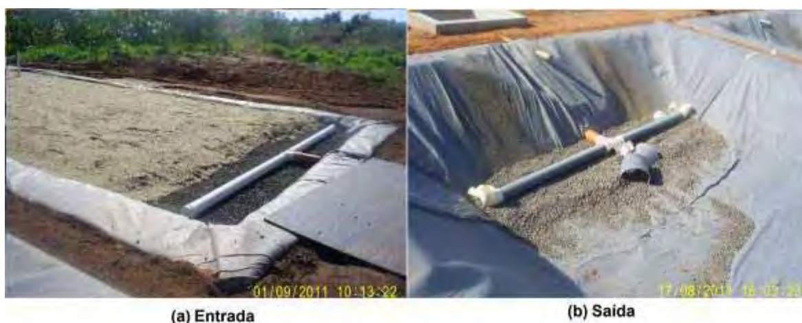
Figura 21 (a) Tubulação de entrada do efluente;
