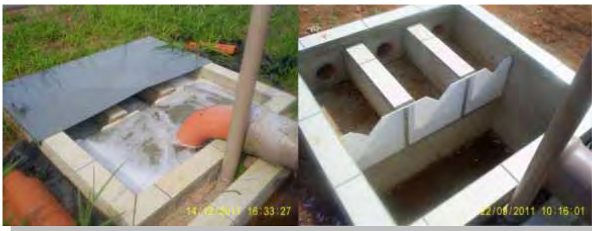
Figura 15 Caixa divisória de vazão
