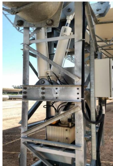
Figura 9 – Pistão hidráulico do sistema de rastreamento de um SCA
