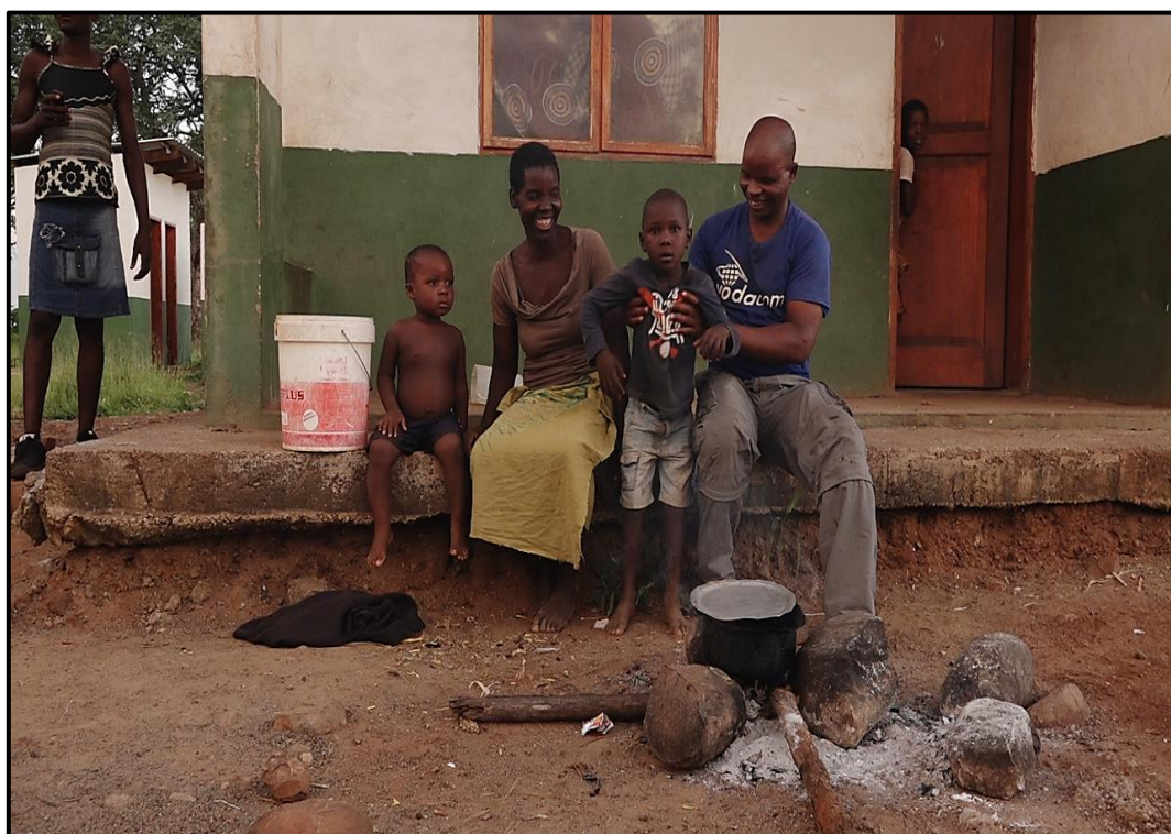
Fotografia 51 - Erosão sob alicerce duma casa em Cateme.
