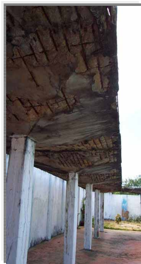
Figura 1.2 – Efeito da corrosão numa laje de concreto da mesma edificação.
