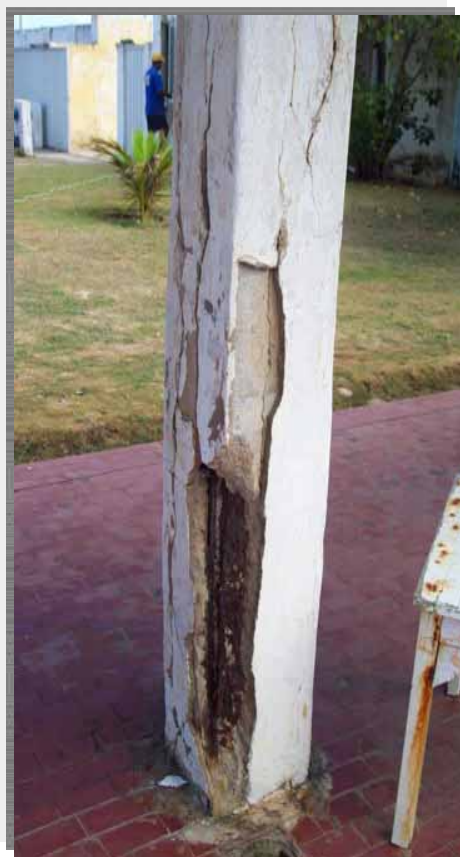
Figura 1.1 – Efeito da corrosão num pilar de sustentação, em concreto, de edificação localizada na Praia do Futuro.
