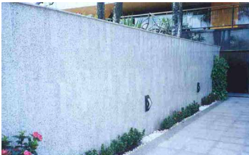
Figura 1.4 – Revestimento externo em prédio, localizado na Avenida Beira Mar (Fortaleza-Ce), apresentando surgimento de manchas ferruginosas esparsas, devido a provável oxidação de minerais máficos.
