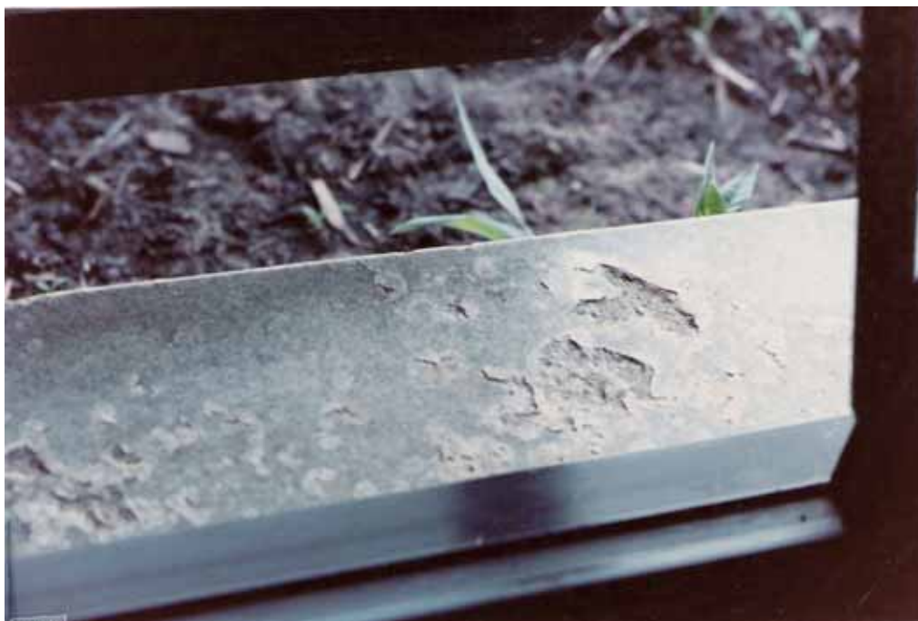
Figura 1.3 – Escamação em placa granítica, assemelhando-se a uma espécie de corrosão superficial (peitoril da janela). Apartamento localizado na Avenida Beira Mar em Fortaleza-Ce.
