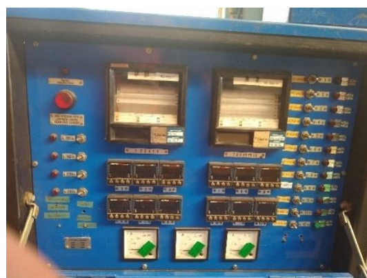
b) Painel de controle
