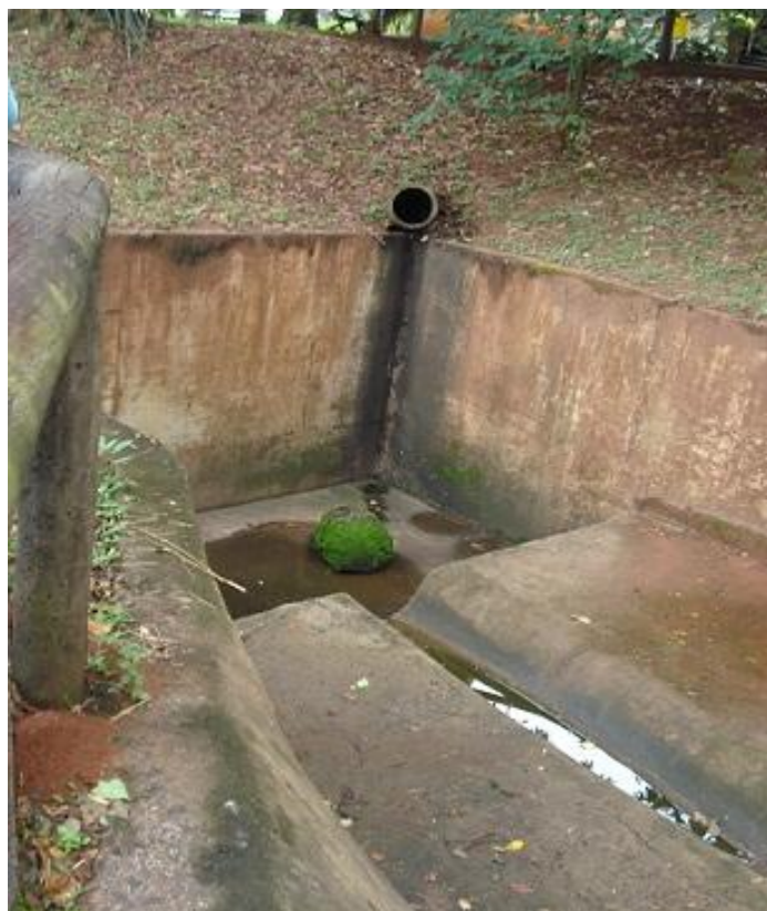
Figura 26 – Uma das galerias que drenam água pluvial externa para o interior do Parque. Fonte: fotos da autora.
