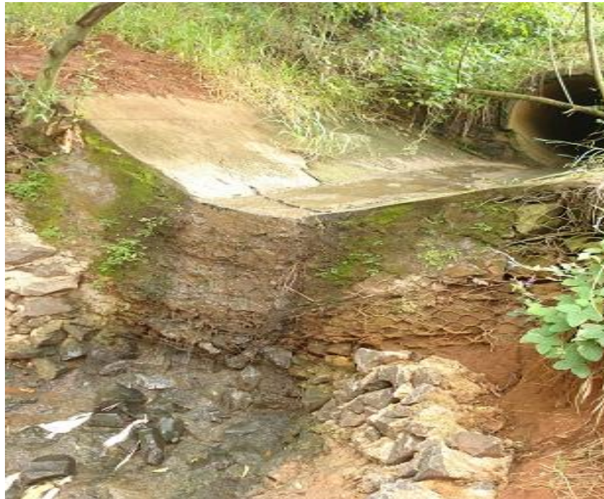
Figura 37 – Galeria de drenagem de água pluvial externa para o interior do parque. Fonte: fotos da autora.
