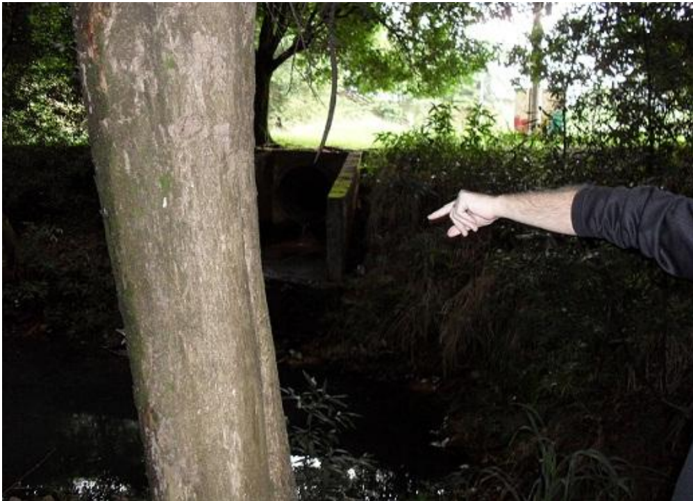
Figura 32 – Galeria de drenagem de águas pluviais externas. Diretamente na nascente. Fonte: fotos da autora.
