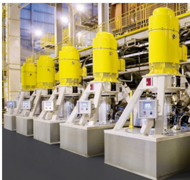
Figura 39 – Instalação típica de centrífugas de batelada tipo MAC1800MIL.
