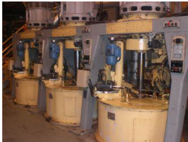
Figura 37 – Instalação típica de centrífugas de batelada tipo V1000.
