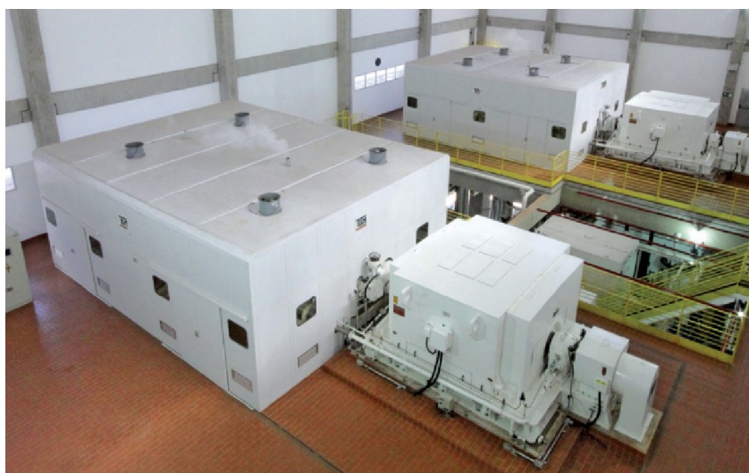
Figura 29 – Conjunto turbina gerador.
