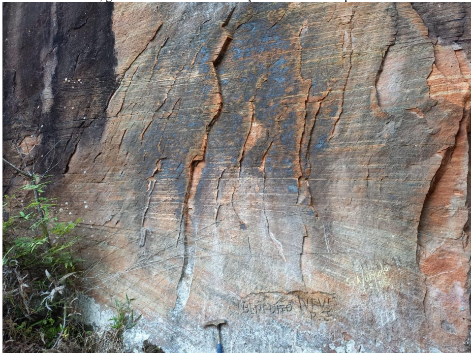
Figura 73: Ponto RM-13, gruta de arenitos da Formação Botucatu com provável sinistral N10W/86NE.
