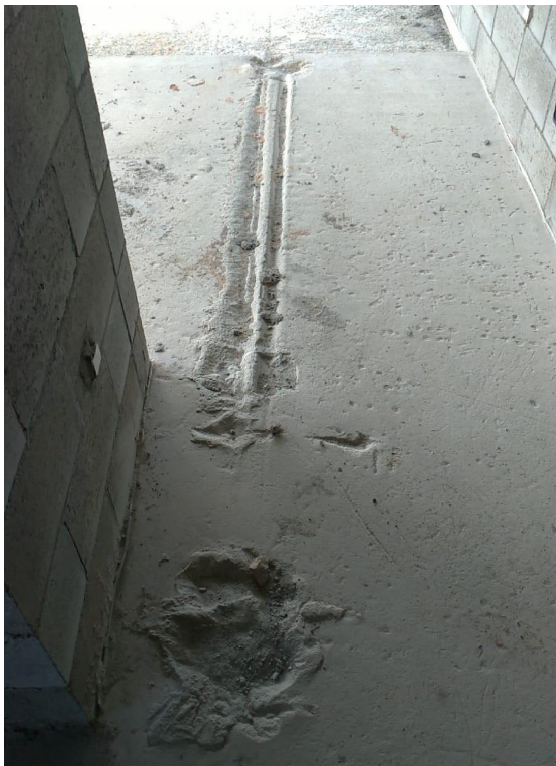
Figura 26 – Falhas por rompimento das barreiras de isolamento
