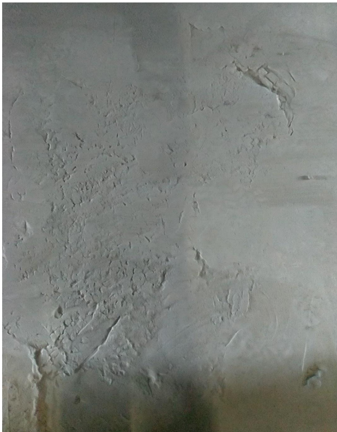
Figura 25 – Falhas de nivelamento e planicidade
