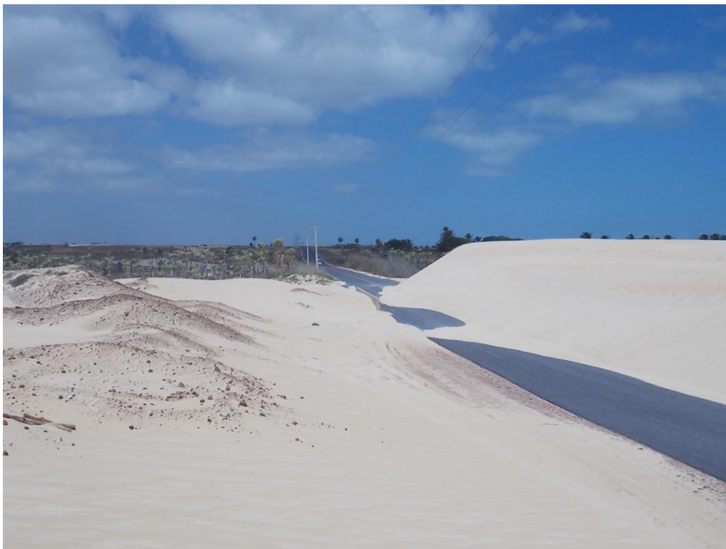
Figura 3.4 – Soterramento da rodovia pela movimentação de depósitos eólicos
