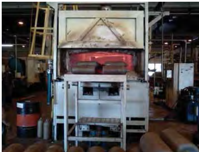
Figura 17 – Forno de tratamento térmico (MAT SA, 2011).
