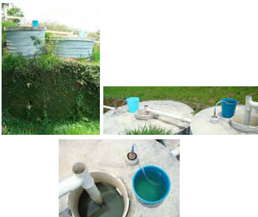
Figura 7.4 – Foto ilustrativa dos pontos de coleta de biogás no UASB I e no UASB II
