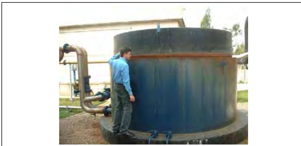
Figura 2.7 – Gasômetro do tipo telescópico em aço para armazenamento de biogás em indústria cervejeira em operação.
