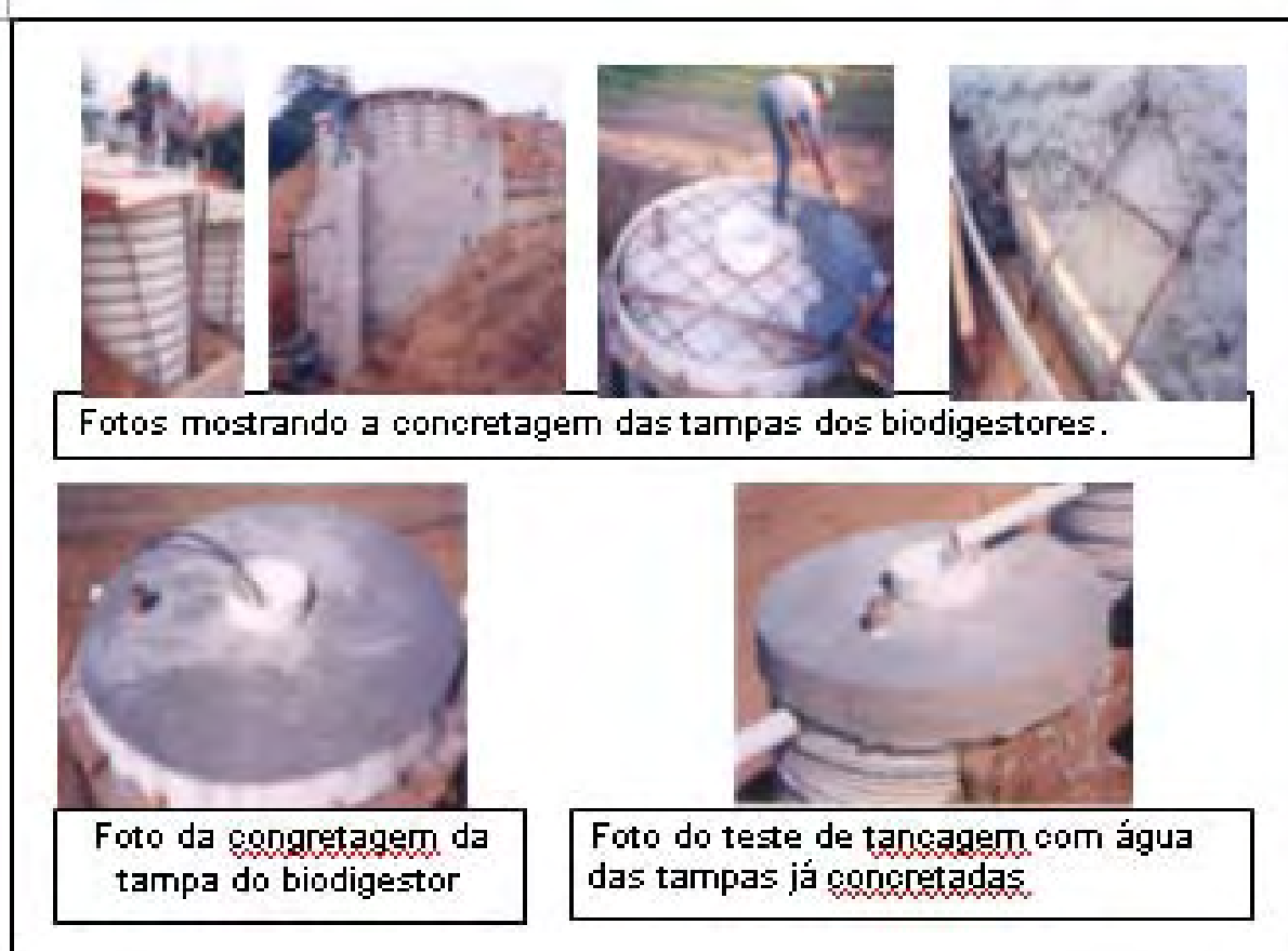
Figura I.8 - Foto da concretagem da tampa dos biodigestores anaeróbios e dos ensaios de tancagem e estanqueidade a gases.
