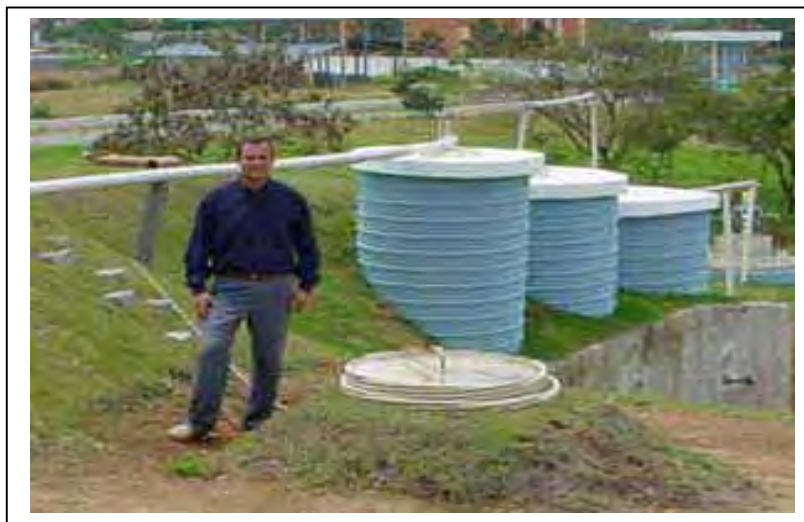
Figura 4.12 – Vista do sistema otimizado de biodigestores anaeróbios de fluxo ascendente em manto de lodo implantado na UNESP - Guaratinguetá, SP, com volume útil de 46 m 3 .
