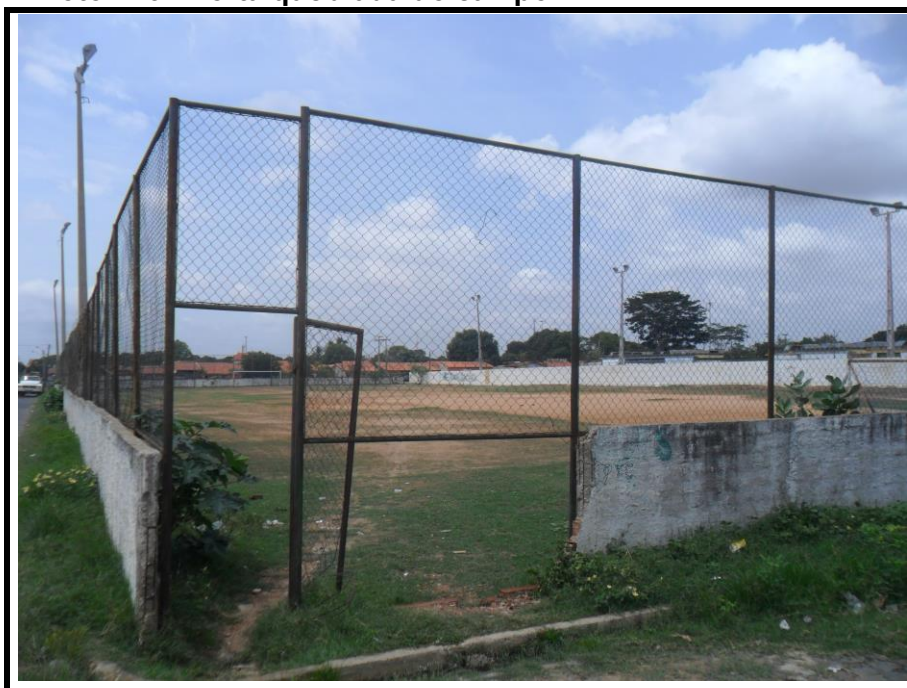
Foto 116 - Porta quebrada do campo
