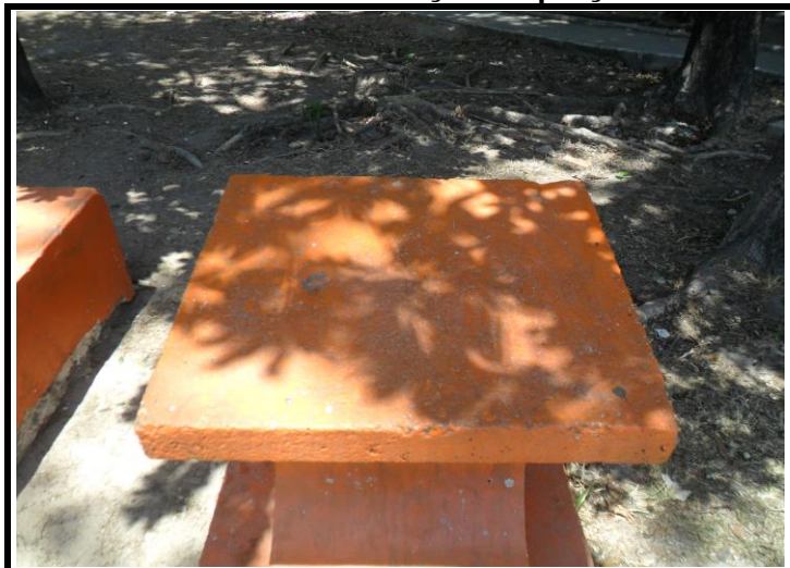
Foto 88 - Placa de identificação da praça danificada
