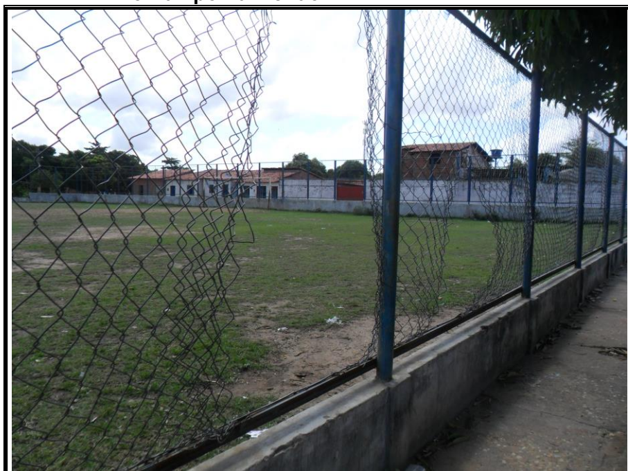
Foto 73 - Alambrado danificado e traves enferrujadas no Campo Palmeirão
