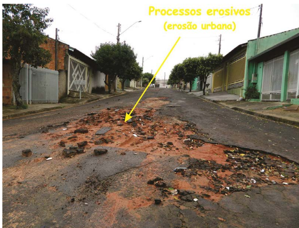
Figura 62. Erosão urbana provocada pela concentração e velocidade da enxurrada. Data: abr/2012
