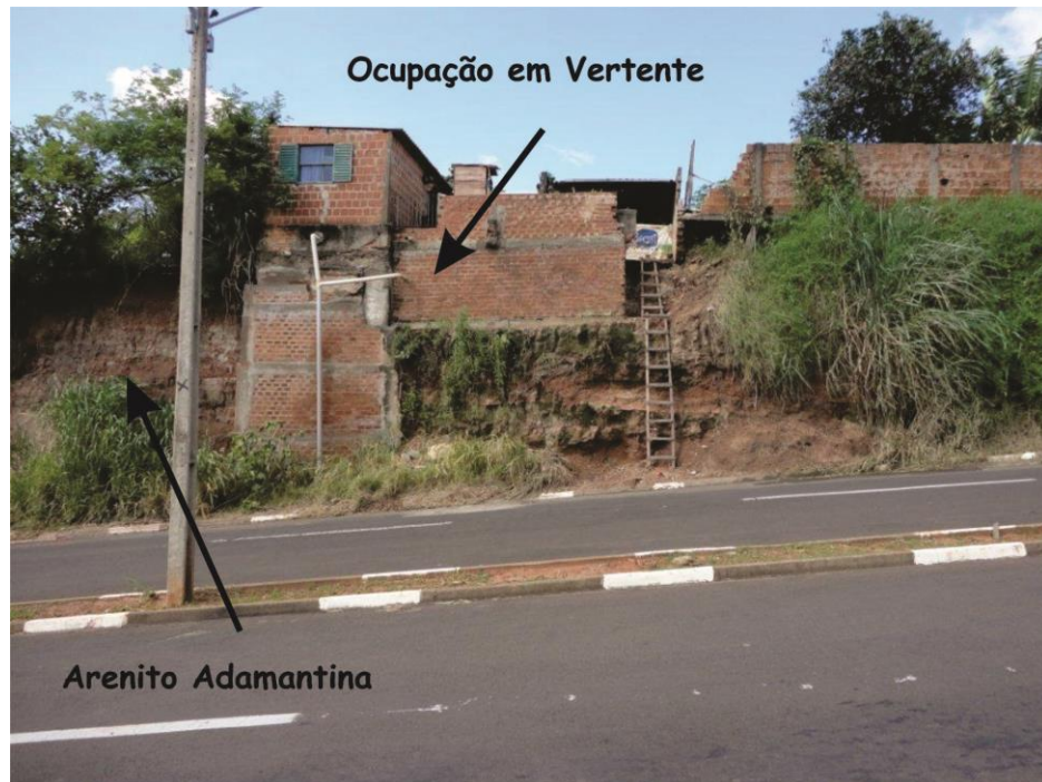
Figura 39. Destaque para ocupação de vertente com declividade acentuada. Observa-se que foi esculpura a vertente, por meio de um corte (zona leste sentido norte). Nota-se a exposição do arenito. Data: dez/2012
