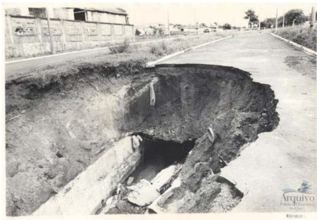
Figura 19 – Subsidência causada por rompimento de galeria de captação de águas pluviais. Foto: Arquivo Público Histórico de Rio Claro. Sem data.
