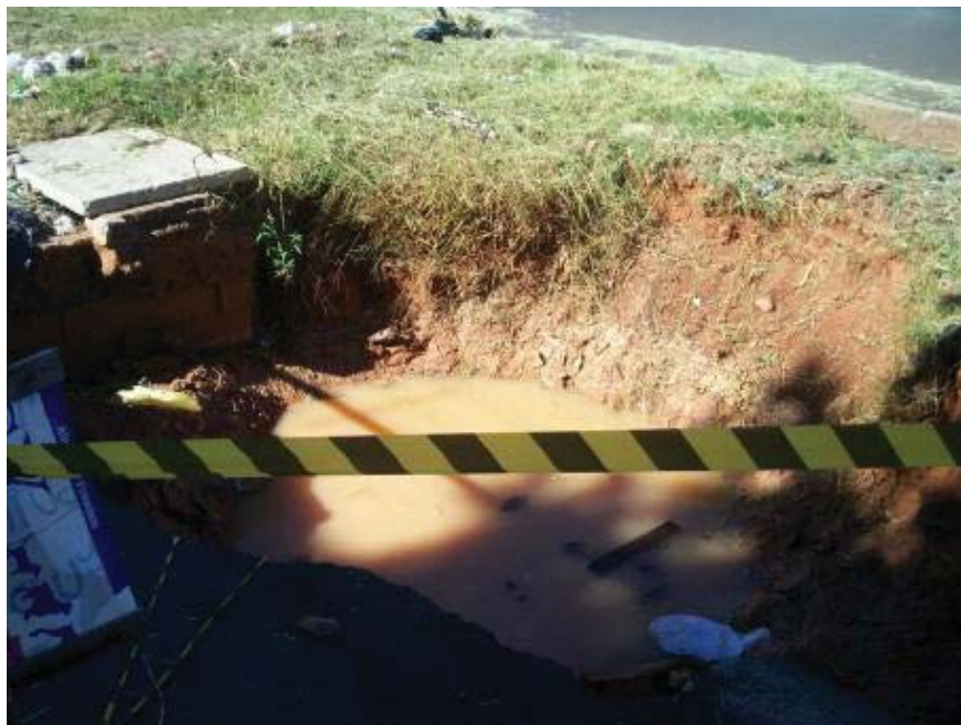
Figura 20 – Início de subsidência causada por rompimento de galeria fluvial na Avenida Ulisses Guimarães. Foto: Alessandra Fagundes, 18/02/2012.
