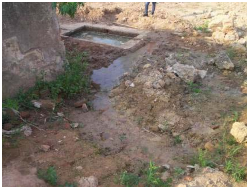
Figura 23 – Afloramento d'água no terreno localizado entre as Avenidas 8-A e Ulisses Guimarães. Foto: Alessandra Fagundes, 13/09/2012.
