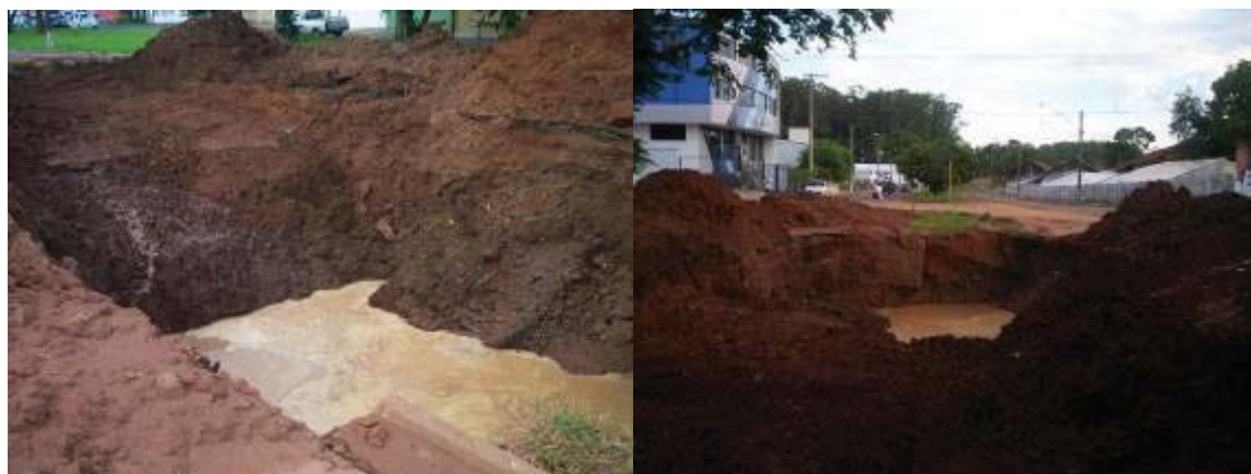
Figura 21 – Subsidência causada por rompimento de galeria de captação de águas pluviais em 2012. Foto: Alessandra Fagundes, 02/03/2012.
