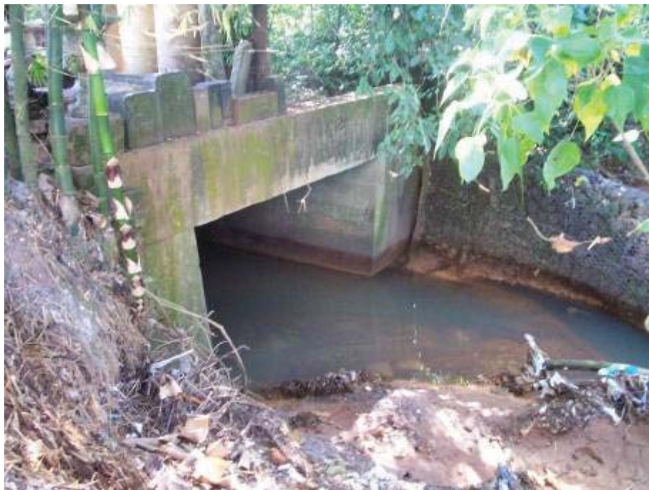
Figura 24 – Local onde ocorre o término da canalização do Córrego Lavapés. Destaque para a tonalidade da água e quantidade de sedimentos e resíduos sólidos acumulados (canto inferior direito da foto).
