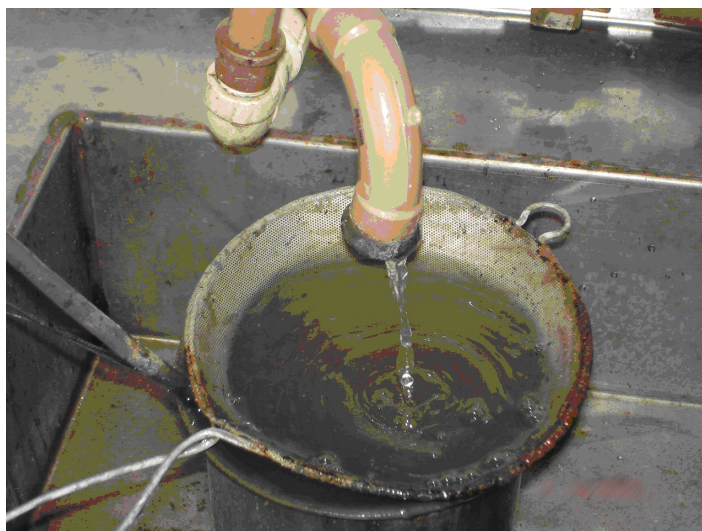
Figura 5.4 – Tubulação de chegada do esgoto bruto no laboratório.
