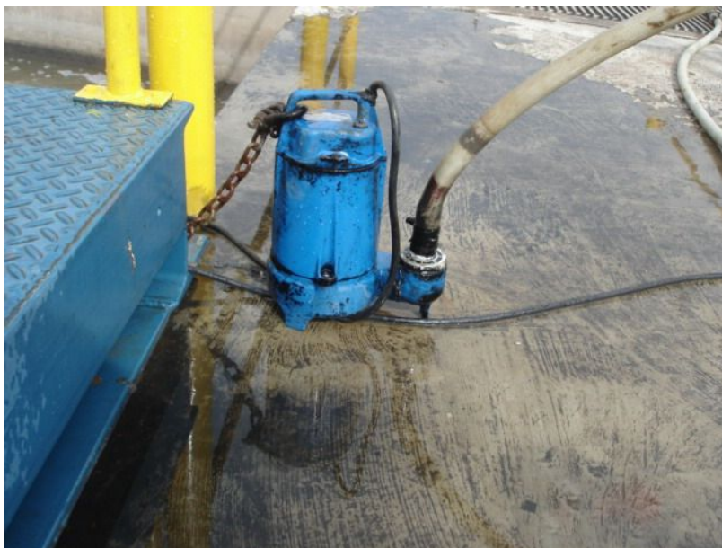
Figura 4.13 – Bomba de captação do esgoto bruto
