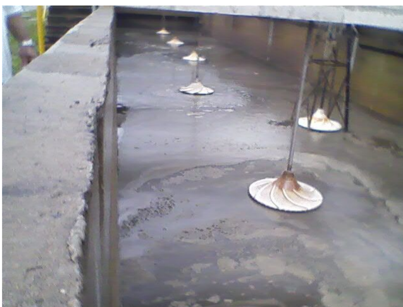
Figura 3.2 – Misturadores hiperbólicos – Tanque de aeração da ETE Limoeiro
