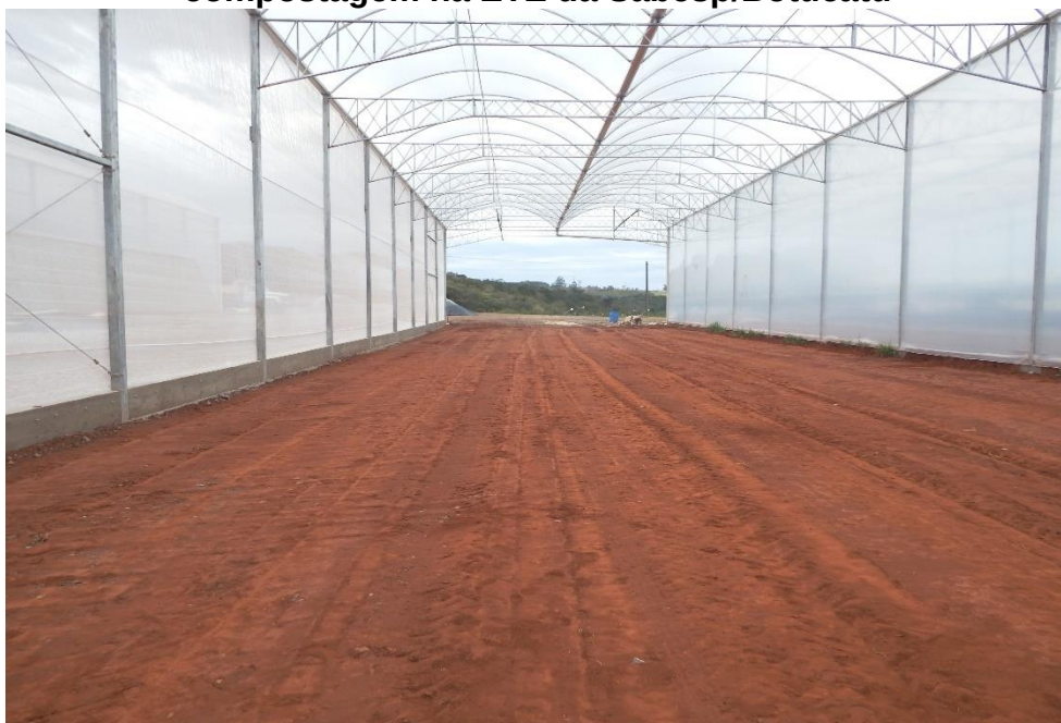
Figura 3 – Interior da estrutura (pátio) construída para montagem das pilhas de compostagem na ETE da Sabesp/Botucatu
