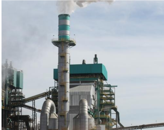
Figura 20 - Imagem de caldeira de usina de cana-de-açúcar.
