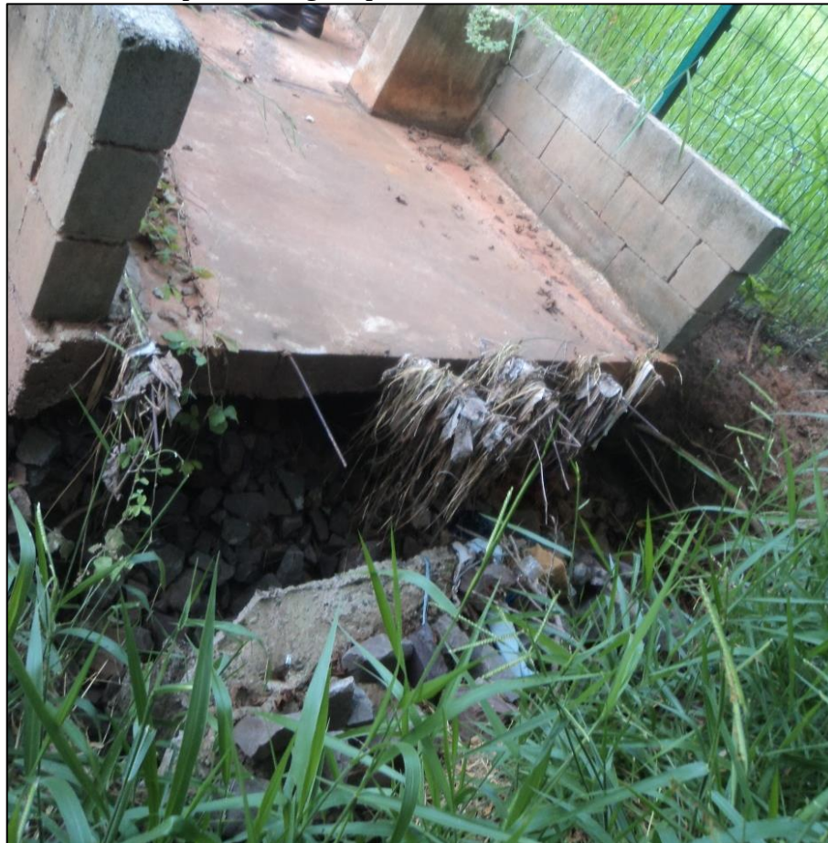
Foto 27 - Dissipador de águas pluviais
