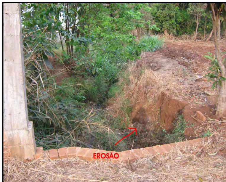
Fig. 44 - Margem direita com erosão e presença de quantidade exígua de mata ciliar.
