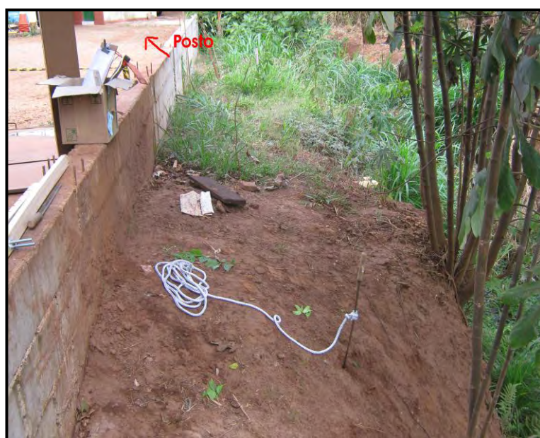
Fig. 43 - Margem esquerda do Córrego com erosão ao lado do posto de gasolina
