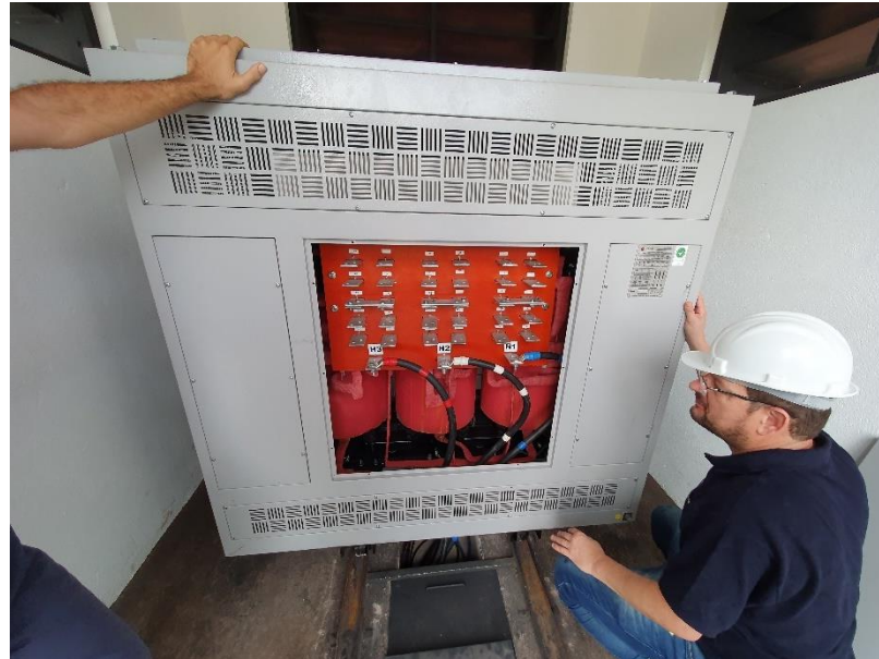
Figura 18- Transformador do BESS 350kVA, 460/380 V.
