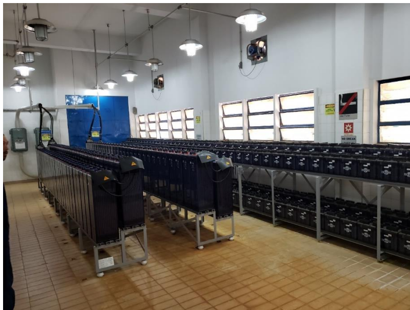
Figura 7- Banco de Bateria UHE Itumbiara
