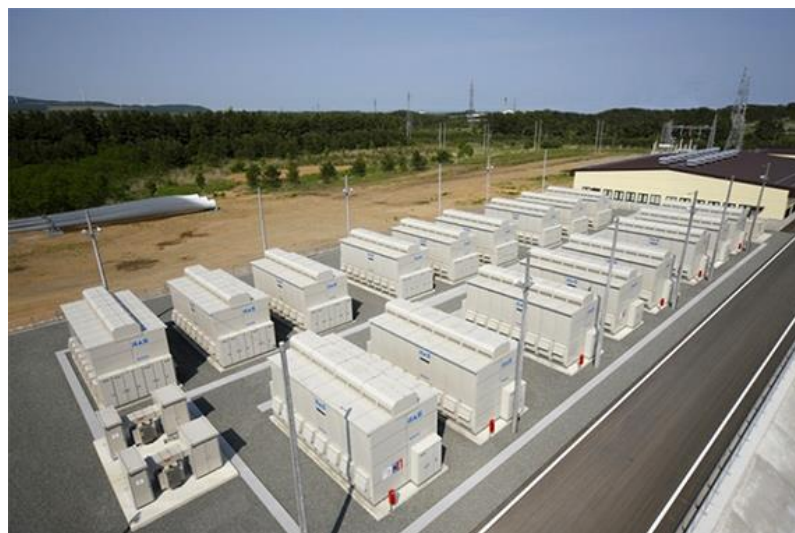
Figura 10- Banco de baterias de Sódio-Enxofre
