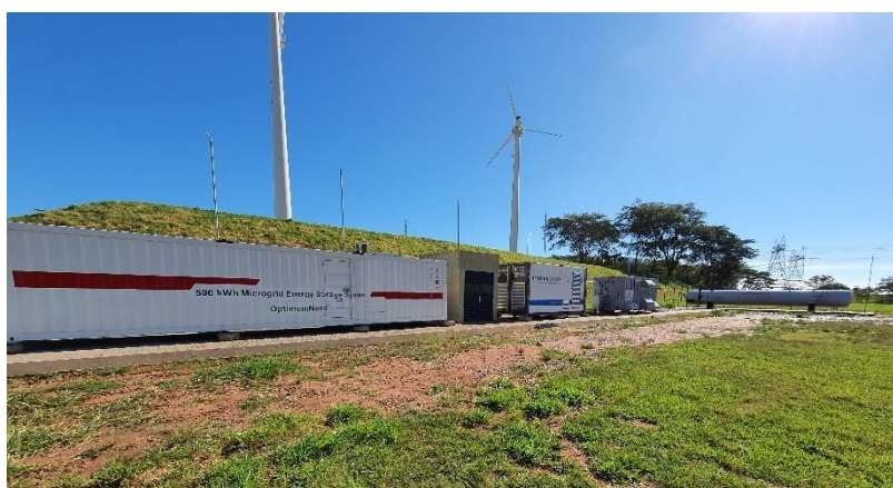
Figura 17- Setor de armazenamento do P&D da UHE Sérgio Motta: Banco de baterias, célula a combustível, eletrolisador e Tanque de Hidrogênio
