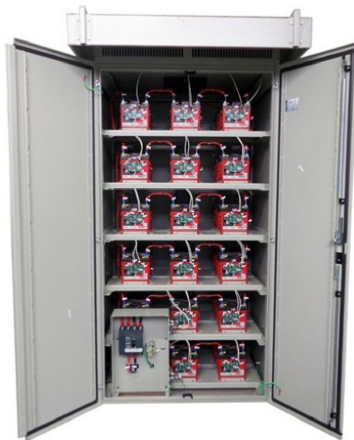
Figura 21 - Sistema de armazenamento por baterias de íons de lítio.
