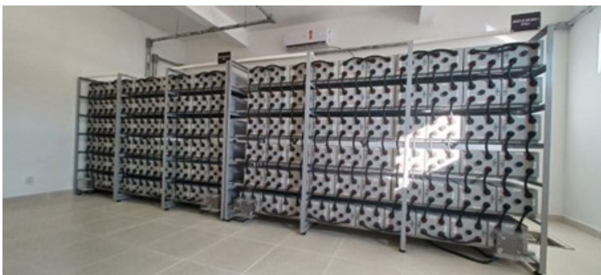
Figura 19 - Sistema de armazenamento por baterias de Chumbo-Ácido.
