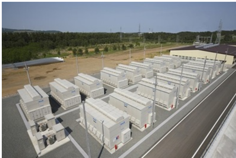
Figura 20 - Sistema de armazenamento por baterias de Sódio-Enxofre.
