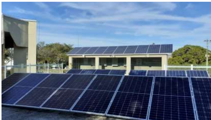
Figura 18 – Painéis fotovoltaicos da central de geração em funcionamento.
