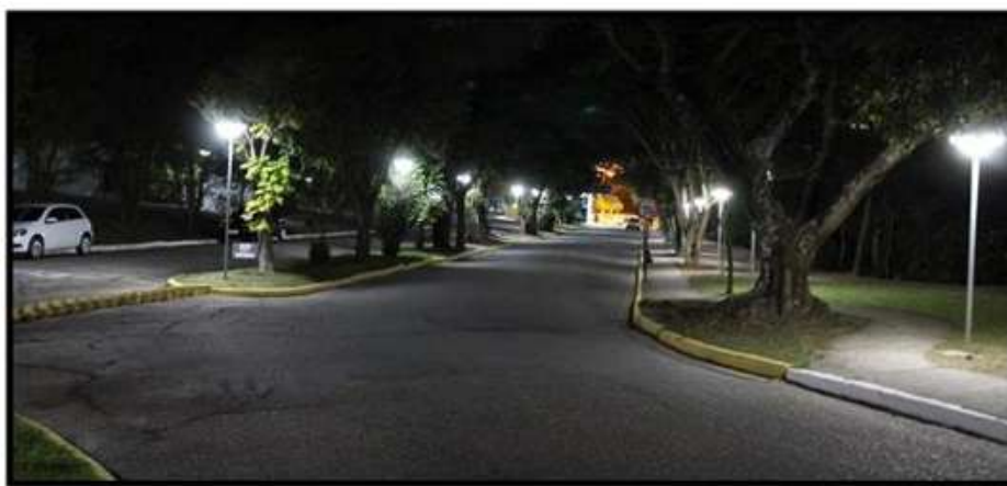
Figura 13 – Sistema de iluminação externa modernizado do campus.
