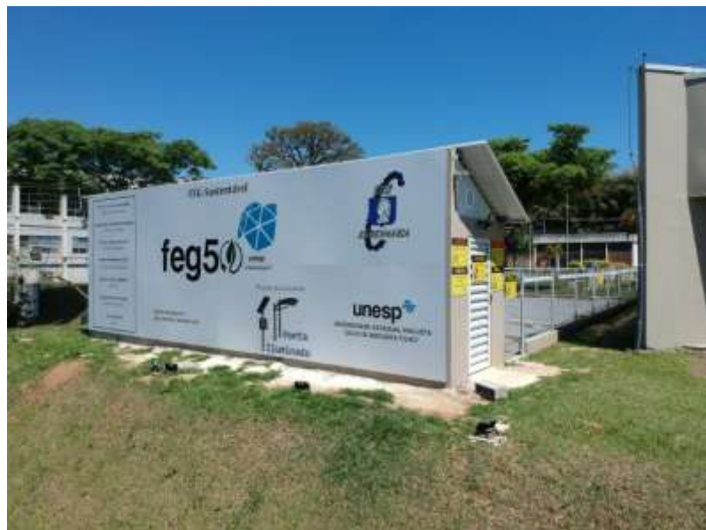
Figura 17 – Estrutura da central de geração.
