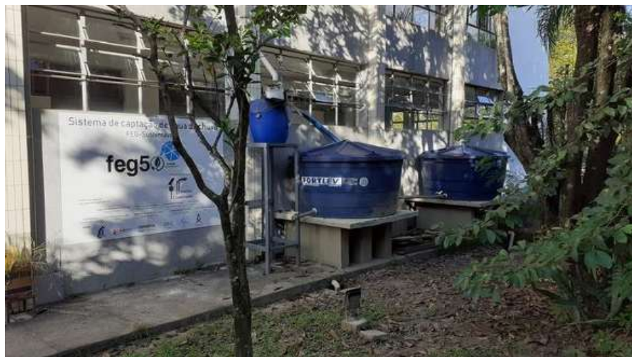
Figura 20 – Sistema de captação de água da chuva.
