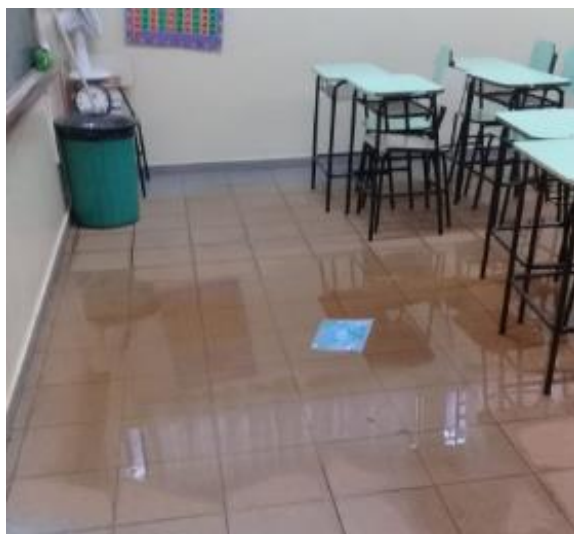
Figura 7: Fotografia de situação de alagamento em sala de aula.
