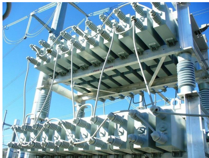
Figura 2. Bancos de Capacitores em Subestação de Distribuição
