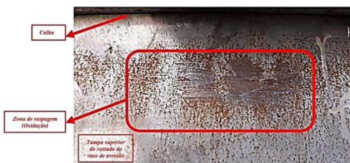
Figura 54 - Superfície externa da chapa do costado, abaixo da calha suporte do isolamento, onde observou-se a presença de uma área com oxidação, sendo ali realizada uma raspagem para remoção do resíduo e caracterização via EDS.
