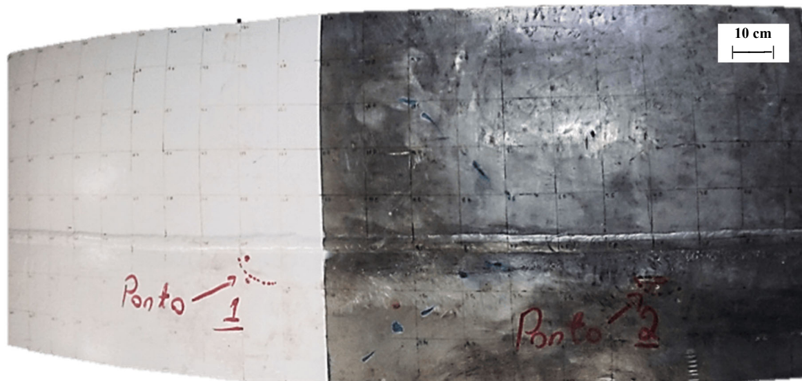
Figura 66 - Vista geral da chapa de teste 1 antes da aplicação do TSA, com os dois primeiros pontos escolhidos.
