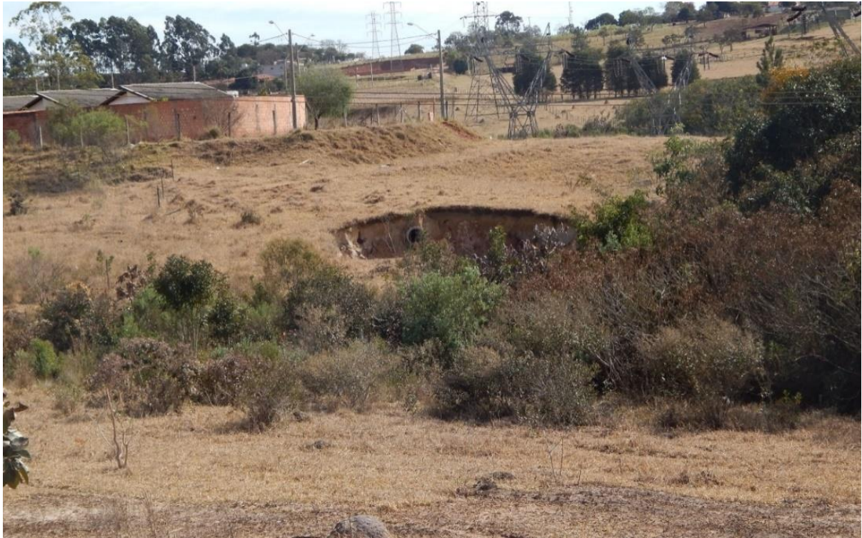
Figura 39: Voçorocamento desenvolvido em consequência da drenagem urbana no bairro Jardim Maria Luiza (Botucatu - SP)
