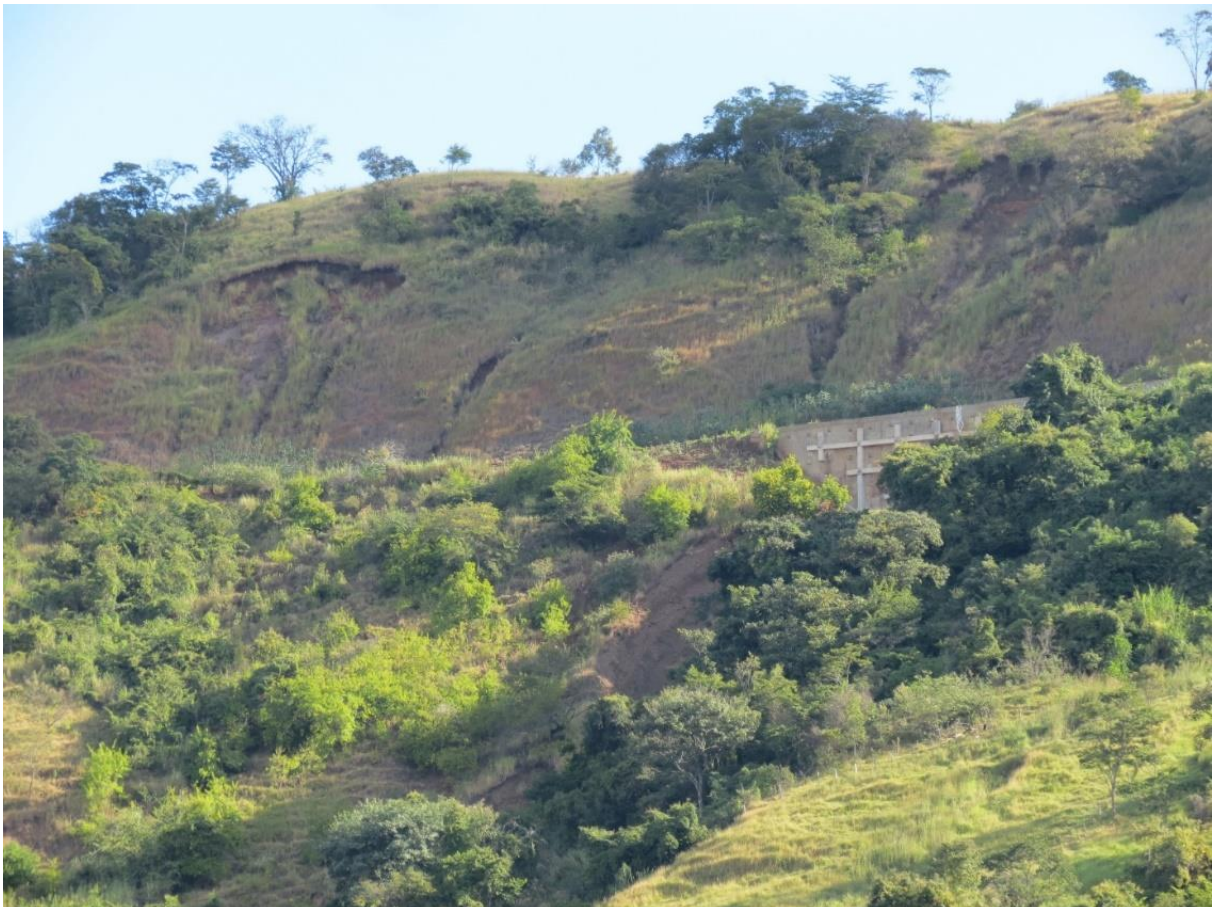
Figura 36: Feições erosivas associadas aos cortes no relevo para a instalação da linha férrea, próximo ao bairro Jd. Vista Linda (Botucatu – SP) Fonte: Os autores, 31/05/2021.
