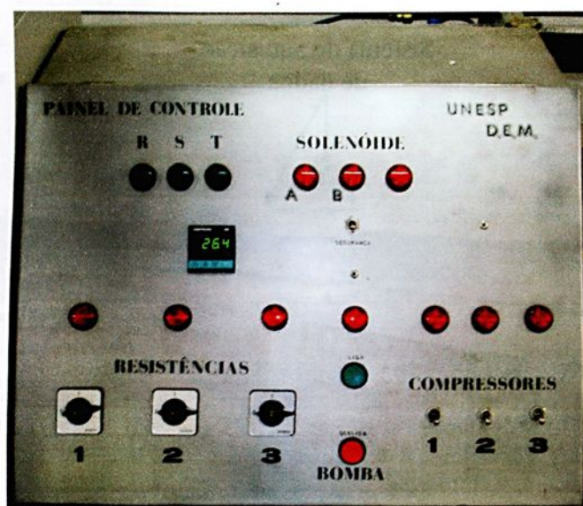
Figura 3.15 – Visualização da parte frontal do painel de comando elétrico
