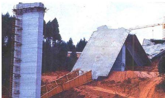
Figura 2 - Colapso da ponte de Injaka, 1998.
