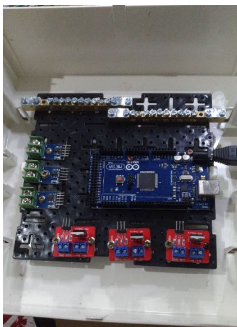
Figura 34 – Montagem dos componentes, painel de controle.
