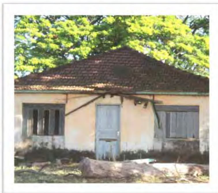
Foto 3: Residência abandonada na microbacia do Córrego do Pereira. Fonte: Trabalho de campo, 2012. Foto: Guilherme Magon Whitacker.
