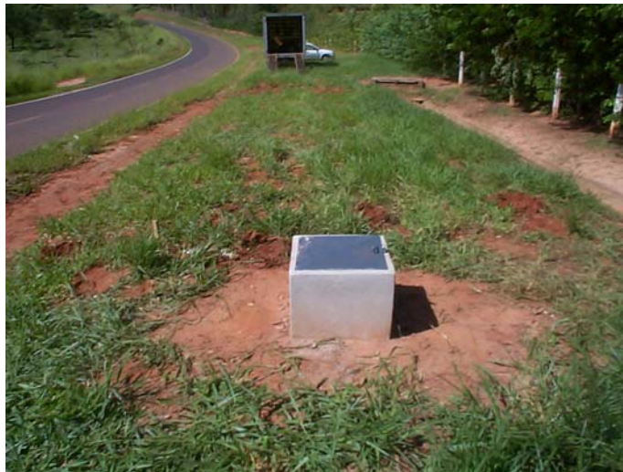
Foto 4.9: Detalhe de um dos poços temporários de monitoramento instalado no aterro de Bauru.
