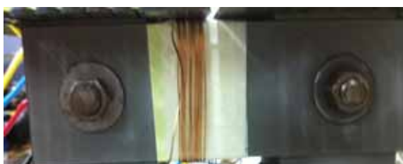
Figura 73 - Detalhe do enrolamento
