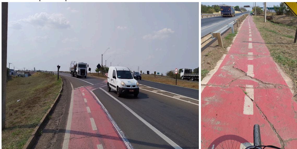
Figuras 41 e 42: Cruzamento da ciclofaixa com a alça de acesso à Rodovia Fausto Santomauro e o pavimento da ciclovia em péssima qualidade.
