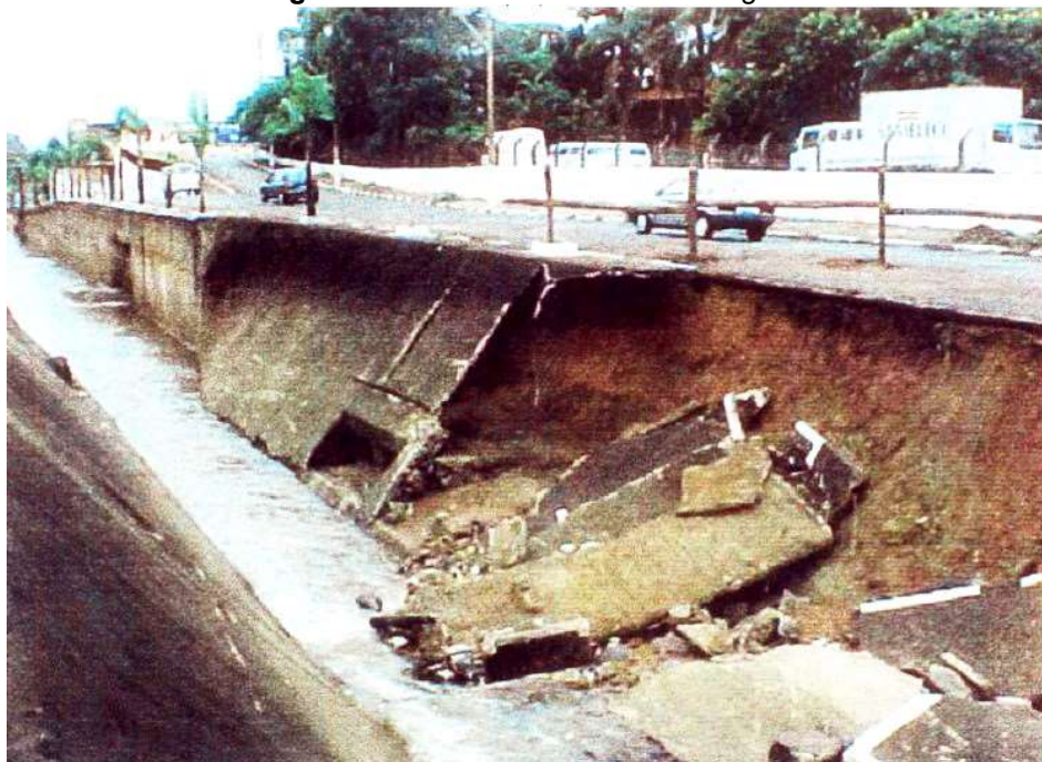
Figura 44 - Erosão no Canal dos Bagres
