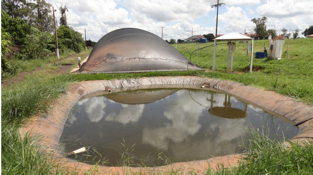
Figura 11: Tanque de efluente e biodigestor.
