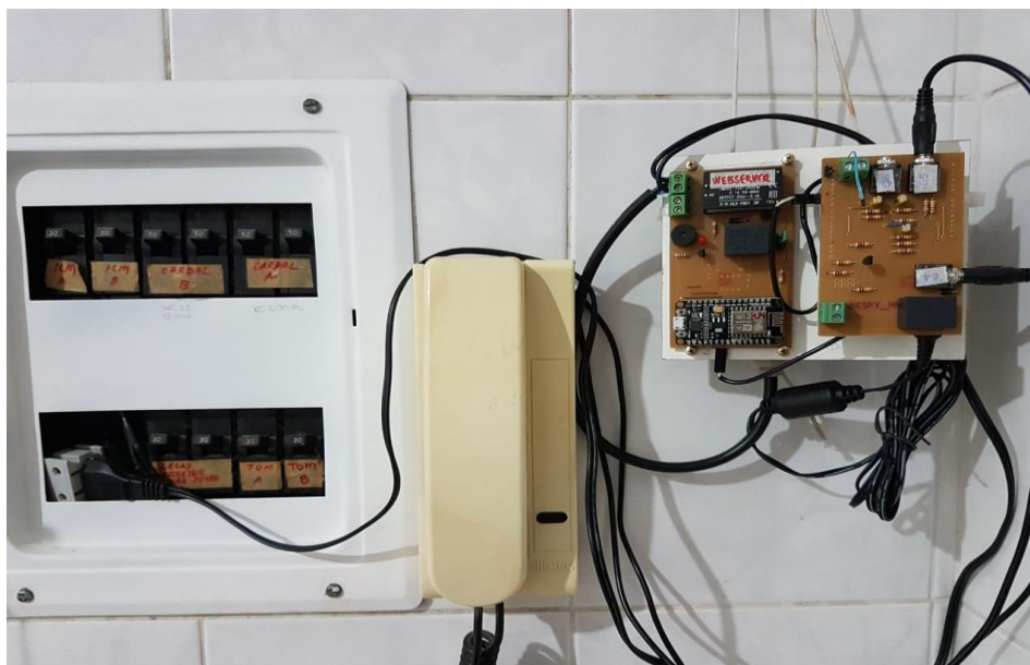
Figura 46– Instalação do Endpoint006 no quadro de distribuição de entrada da residência
