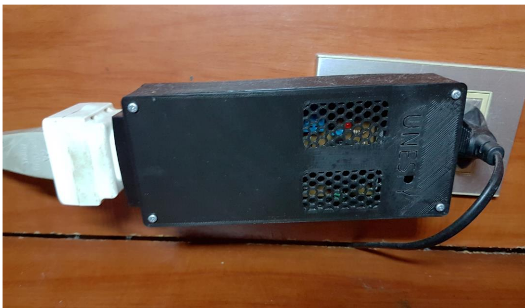
Figura 44 – Instalação do Endpoint004
