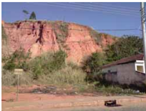
Figura 21 - Vista parcial do talude de corte na encosta. Observa-se a ocorrência de intenso processo erosivo. Coordenadas do local da imagem: 22°51,466' S / 45°13,575' W. Data de registro da imagem: 01/09/2010.
