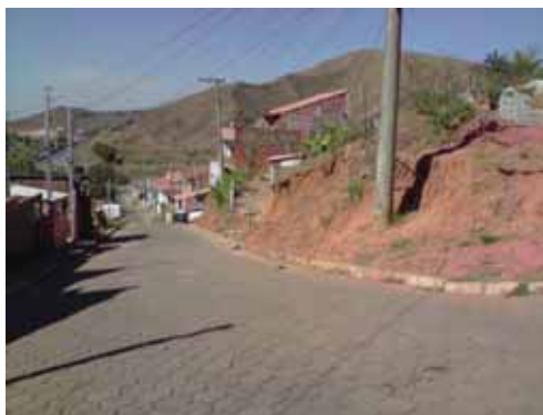
Figura 11 - Vista parcial de via pavimentada no Bairro São Roque/Aroeira. Observam-se as ausências de bocas de lobo e calçadas. Nota-se, também, a características siltosa do solo local. Coordenadas do local da imagem: 22° 49,872' S / 45° 12,743' W. Data da registro: 01/09/2010.
