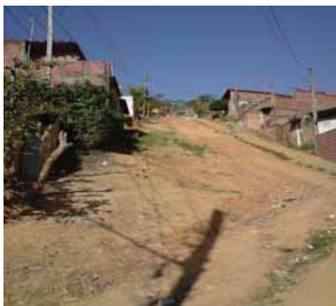
Figura 25 - Vista parcial das edificações implantadas na encosta. Observa-se a alta declividade do terreno e a existência de solo exposto, propiciando a ocorrência de erosões em épocas de elevada precipitação pluviométrica. Coordenadas do local da imagem: 22° 51,829' S / 45° 13,395' W. Data de registro da imagem: 01/09/2010.
