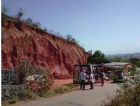
Figura 12 - Vista geral da escavação de encosta para construção de edificação. Observa-se a inclinação acentuada do talude de corte (vertical). Coordenadas do local da imagem: 22° 49,871' S / 45°12,742' W. Data da registro da imagem: 01/09/2010.
