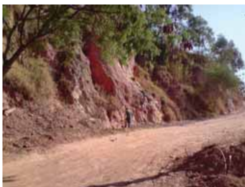
Figura 20 - Vista parcial da via de acesso ao Bairro São Francisco. Observa-se a ocorrência de intenso processo erosivo no talude de corte. Coordenadas do local da imagem: 22°51,516' S / 45°13,450' W. Data de registro da imagem: 01/09/2010.
