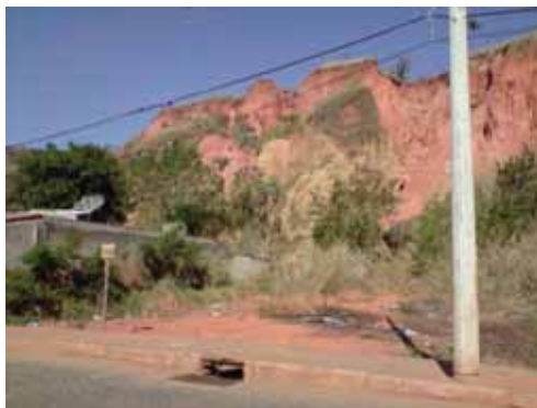
Figura 22 - Vista parcial do talude de corte na encosta. Observa-se a ocorrência de intenso processo erosivo. Coordenadas do local da imagem: 22°51,466' S / 45°13,575' W. Data de registro da imagem: 01/09/2010.
