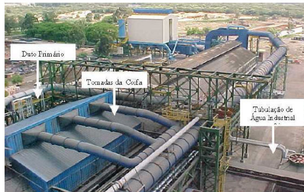
Figura 2.14: Vista superior dos dutos de exaustão de um despoeiramento
