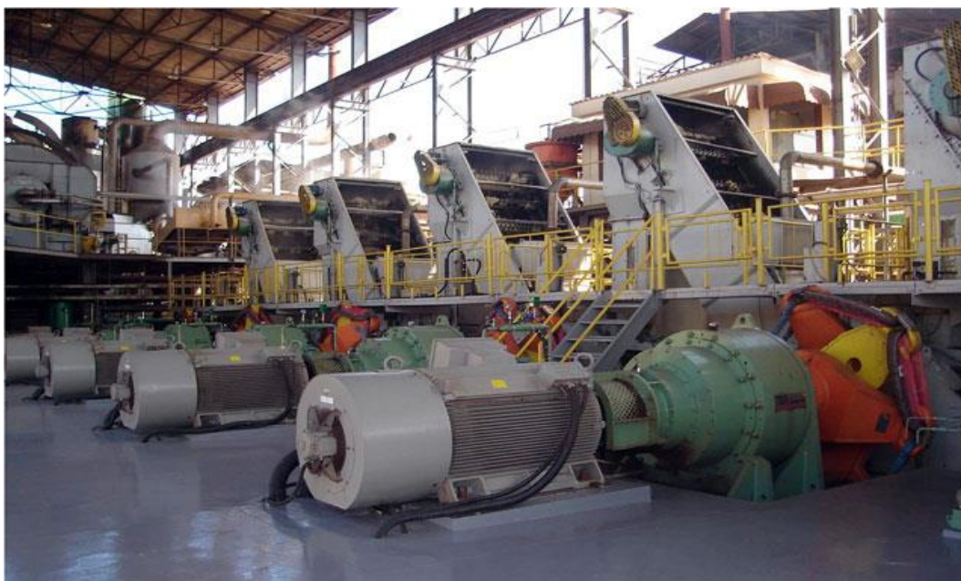
Figura 65 - Acionamento de tandem de moenda com motores elétricos.
