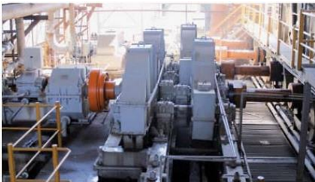
Figura 66 - Redutores de velocidade em acionamento de moenda.
