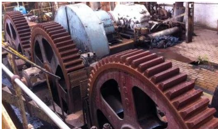
Figura 64 - Sistema de redução de velocidade da turbina para os rolos de moenda.
