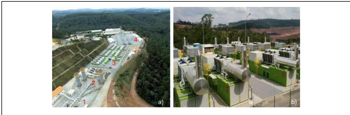
Figura 4 - Sistema de geração elétrica no aterro sanitário de Caieiras - SP
