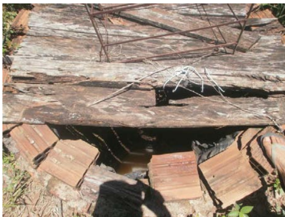
Foto 2 – Poço Caipira inutilizado
