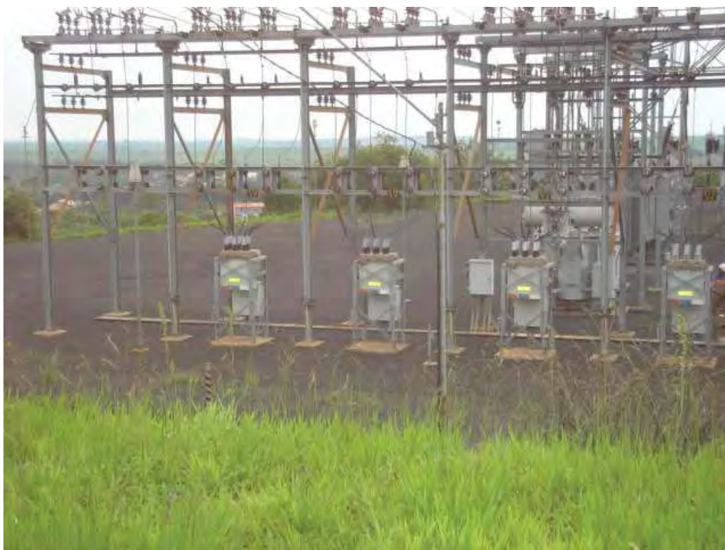
Figura 3.6. Vista da Subestação.
